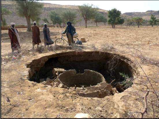
Puits de Koïra Béri effondré
